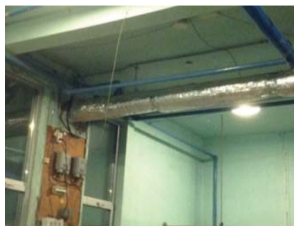
9 • CRÉPI • /113 2015-01-30 19:13 - Administrateur Mur/Plafond Moy. endommagé
