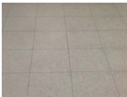
5 • TUILE VINYLE 2015-01-30 19:05 - Administrateur Plancher Peu endommagé
