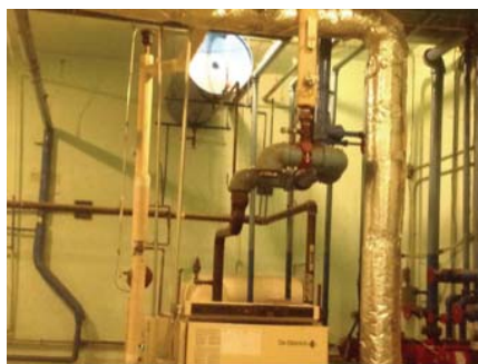
8 • FIBRE DE VERRE (NON MSCA) •... 2015-01-30 19:09 - Administrateur Conduite rectiligne Observation
