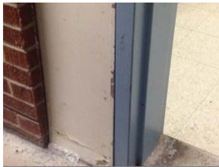
26 • GYPSE 2015-01-30 19:34 - Administrateur Mur Moy. endommagé
