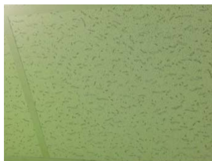
4 • TUILE ACOUSTIQUE 2015-01-30 19:04 - Administrateur Plafond Peu endommagé
