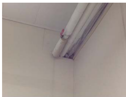
3 • FIBRE DE VERRE (NON MSCA) •... 2015-01-30 19:02 - Administrateur Conduite rectiligne Observation
