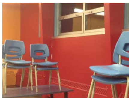
1 • GYPSE • /104 2015-01-30 19:00 - Administrateur Mur Peu endommagé
