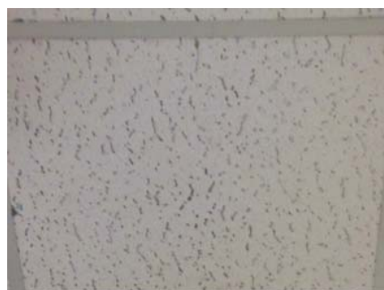
31 • TUILE ACOUSTIQUE • /100 2015-01-30 18:43 - Administrateur Plafond Peu endommagé
