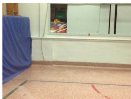
20 • CRÉPI-PLÂTRE • /107 2015-01-30 18:23 - Administrateur Mur Moy. endommagé
