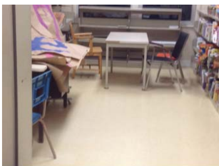
26 • TUILE VINYLE • /214 2015-01-30 18:32 - Administrateur Plancher Peu endommagé
