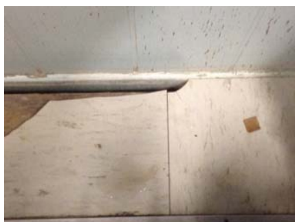
9 • TUILE VINYLE 2015-01-30 18:00 - Administrateur Plancher Très endommagé
