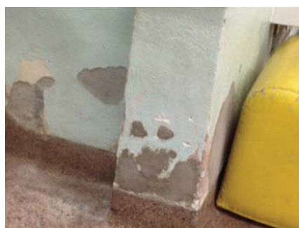
19 • CRÉPI-PLÂTRE • /107 2015-01-30 18:23 - Administrateur Mur Très endommagé
