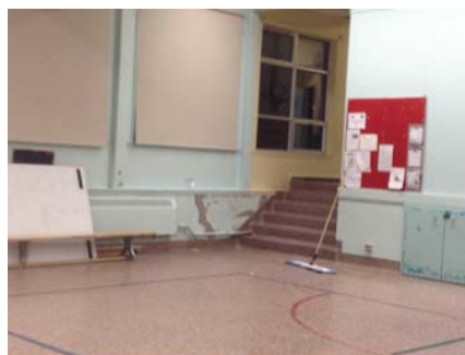
16 • CRÉPI-PLÂTRE • /107 2015-01-30 18:22 - Administrateur Mur Moy. endommagé
