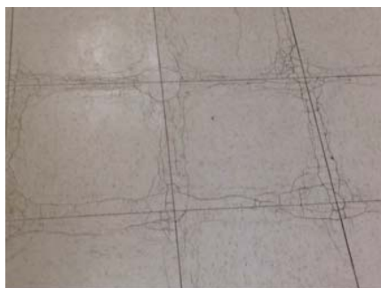
15 • TUILE VINYLE 2015-01-30 18:12 - Administrateur Plancher Moy. endommagé
