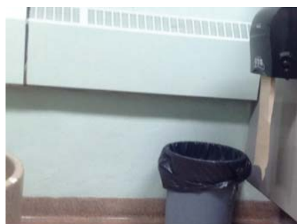
17 • CRÉPI-PLÂTRE • /108 2015-01-30 18:22 - Administrateur Mur Moy. endommagé
